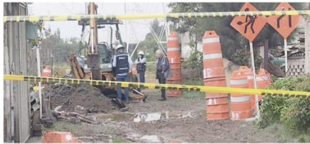
Las lluvias retrasan la reparación del ducto de gas dañado en la colonia Benito Juárez
