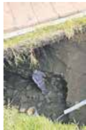
El colapso ocurrió en la glorieta de Calzada del Pacífico y Colón.
