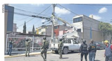
Las autoridades informaron que los dispositivos estaban instalados sin autorización en infraestructura gubernamental.
