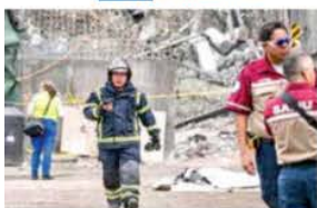
COLAPSA EDIFICIO EN DEMOLICIÓN
